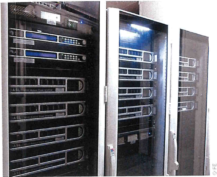
Un des racks d'amplification ASL Control du système JBL de la U Arena. On distingue les douze amplis V2000, plus les Crown DCI 4|2400N alimentant les caissons de graves. Notez également, dans le rack de gauche, les routeurs ASL Control VIPEDIA 12 NET.
